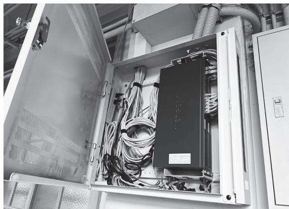
図 11 改修したスイッチ（1階南側ウイング）
