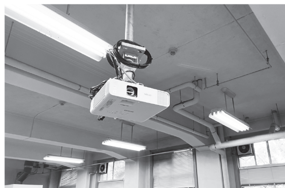
図14 化学実験室に設置されたプロジェクター
