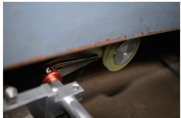
図12 ドームの回転を検知するロータリーエンコーダー
