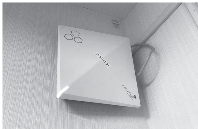
図1 設置された Access Point：Aerohive AP250
