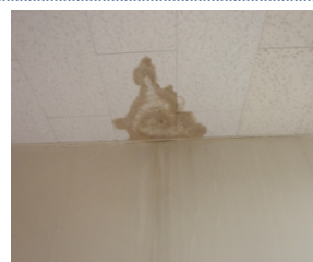
屋根からの雨漏れ
